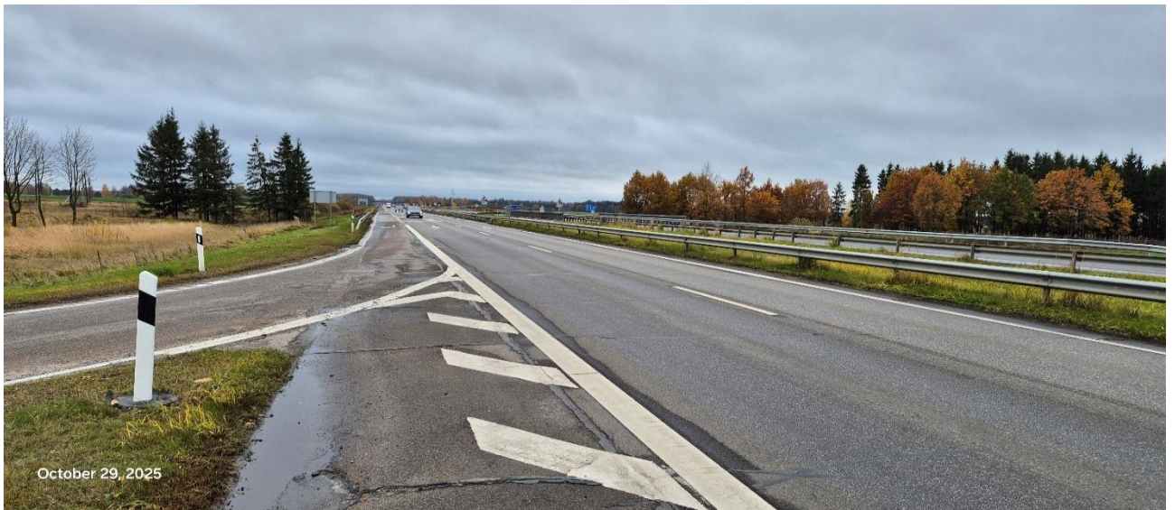
3 pav. Esama situacija už viaduko A2 Vilnius-Panevėžys
