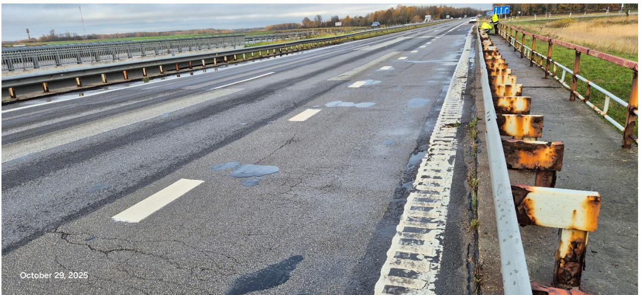
4 pav. Esama situacija ant viaduko 46,194 km A2 Vilnius-Panevėžys
