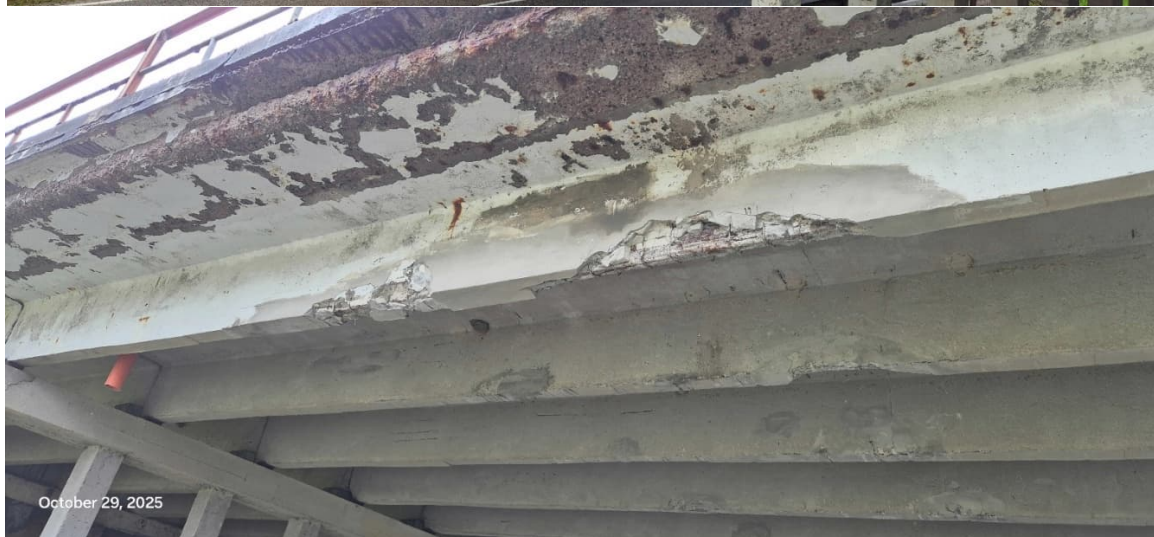
Pav. 3 Perdangos sijose aptrupėjęs betonas, korduojanti armatūra, vidurinės sijos išlinkusios
