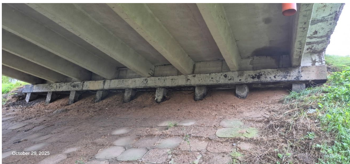
Pav. 4 Kraštinė atrama. Aptrupėjęs apdailinis sluoksnis, pažeistas apsauginis betono sluoksnis.
