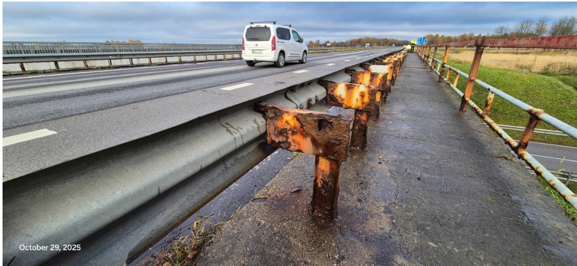
Pav. 2 Atitvarai ir turėklai stipriai sukorodavę
