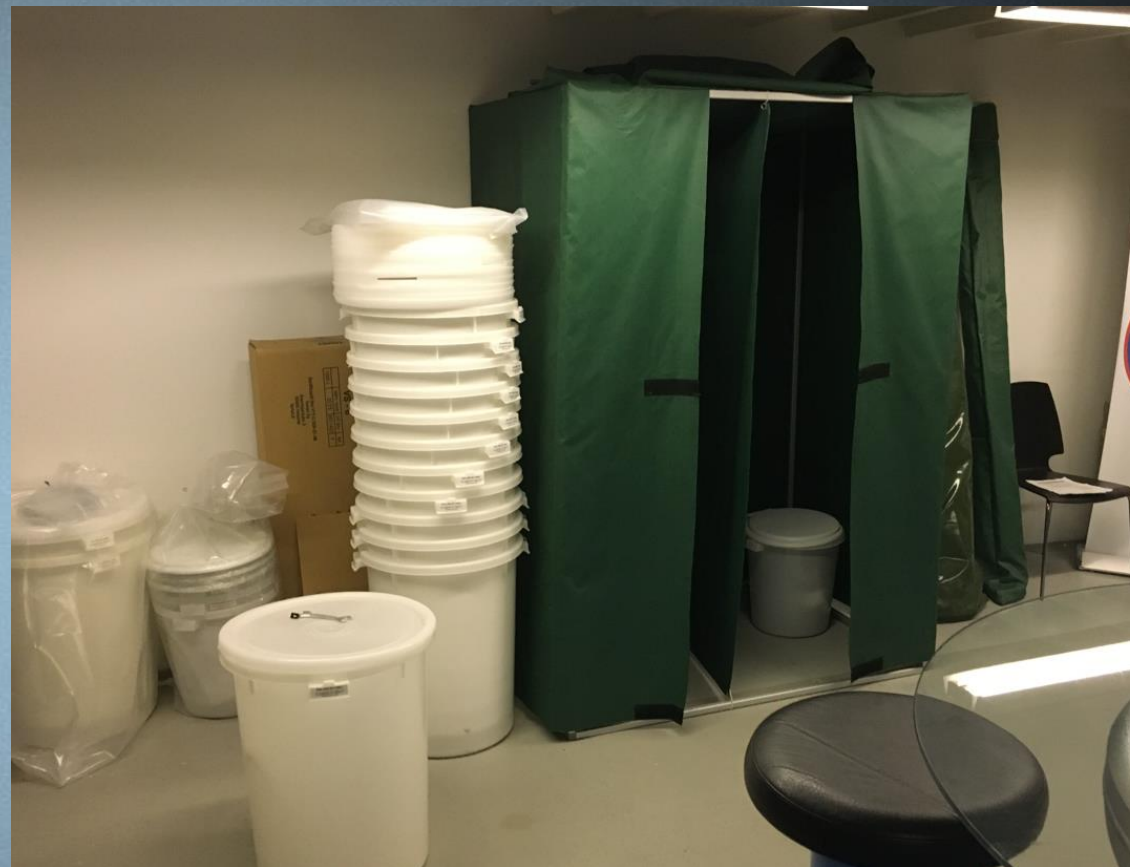
Pav. 2 kabinų slėptuvės sanmazgas paruoštas eksploatacijai
